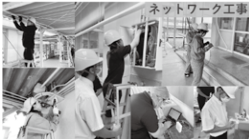
図5 無線アクセスポイント設置の様子
