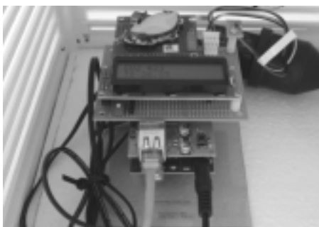
図7 屋上緑化計測システム本体
