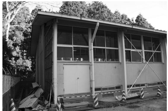
＜損壊した格技場＞
