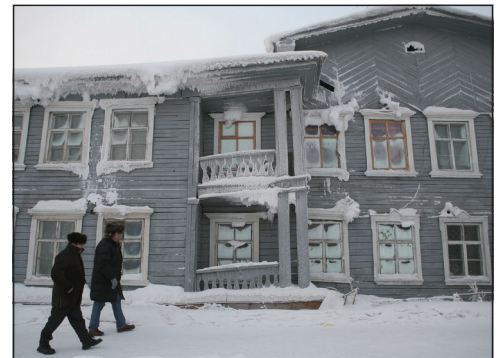
5 凍土融解による地盤沈下でゆがんだ家屋 2005年。ロシア。ヤクーツク。
